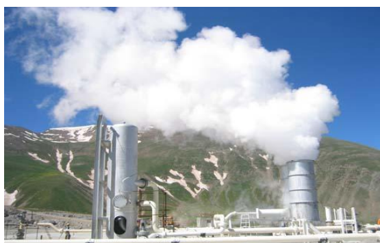
شکل ۱۲ نیروگاه زمین گرمایی مشکین شهر که با توان تولیدی ۱۰۰ مگاوات نصب شده است.
